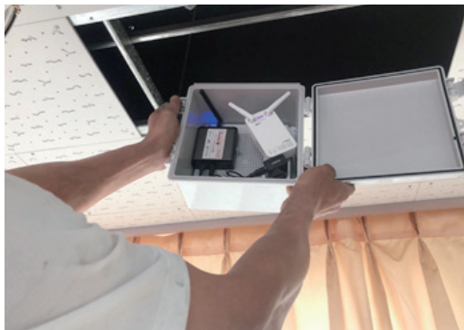
비콘스캐너, 무선확장기 설치
